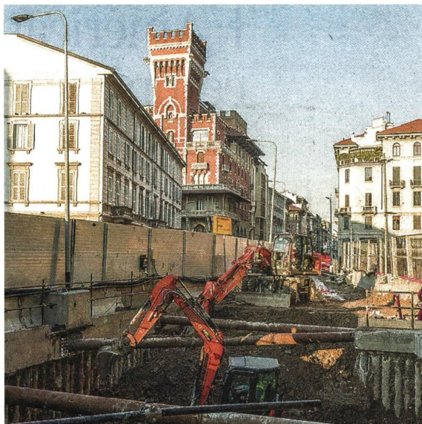
Scavi La futura fermata Sant' Ambrogio della «blu», intersezione con la linea «verde» (Ansa)
